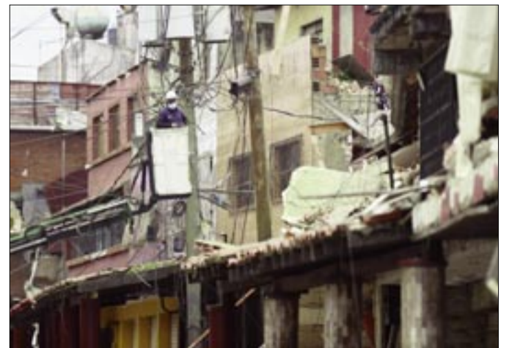
UN HOMBRE TRABAJA ESTE SÁBADO, EN UNA ZONA AFECTADA POR LOS TERREMOTOS EN VENEZUELA, EN EL JUNQUITO (VENEZUELA). EFE
