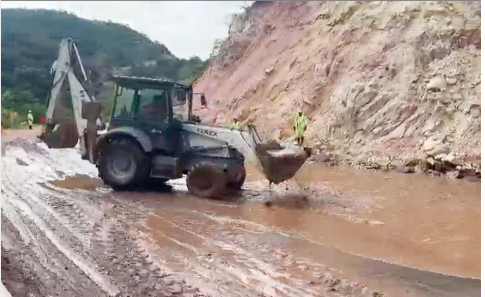
CAMINO AL CHACO ESTÁ DETERIORADO.
