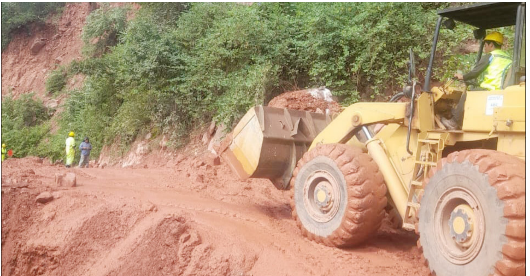
NUEVOS DERRUMBES OBLIGAN A UN TRABAJO DE LIMPIEZA MÁS INTENSO.
