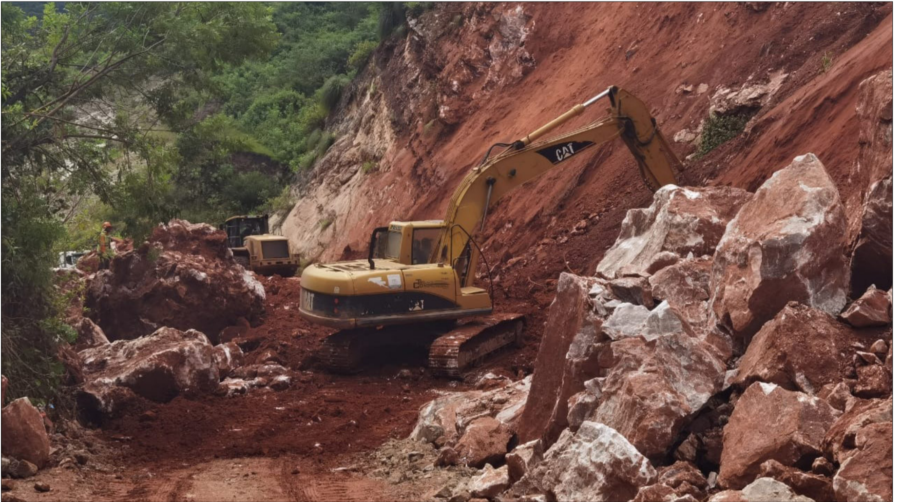
DERRUMBES DE MAGNITUD OBLIGARON A INTENSO TRABAJO ININTERRUMPIDO.
