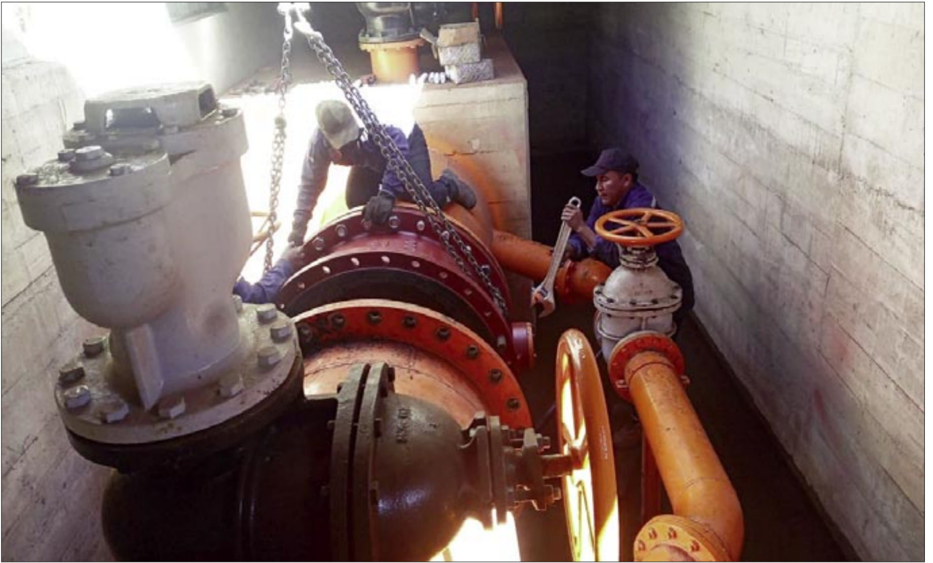
EL SISTEMA DE RIEGO DE SAN JACINTO, PRECISA NUEVA TUBERÍA PRINCIPAL DE DISTRIBUCIÓN DE AGUA.
