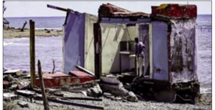
UNA CASA YACE COMPLETAMENTE DESTRUIDA TRAS EL PASO DEL HURACÁN MELISSA EN LA LOCALIDAD DE BOCA DE DOS RÍOS, EN LA PROVINCIA DE SANTIAGO DE CUBA
