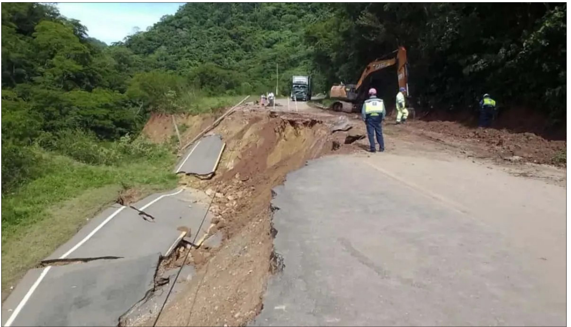
ASÍ SE DESTRUYERON, EN VARIOS PUNTOS, LA CARRETERA EN SAMAIPATA.
