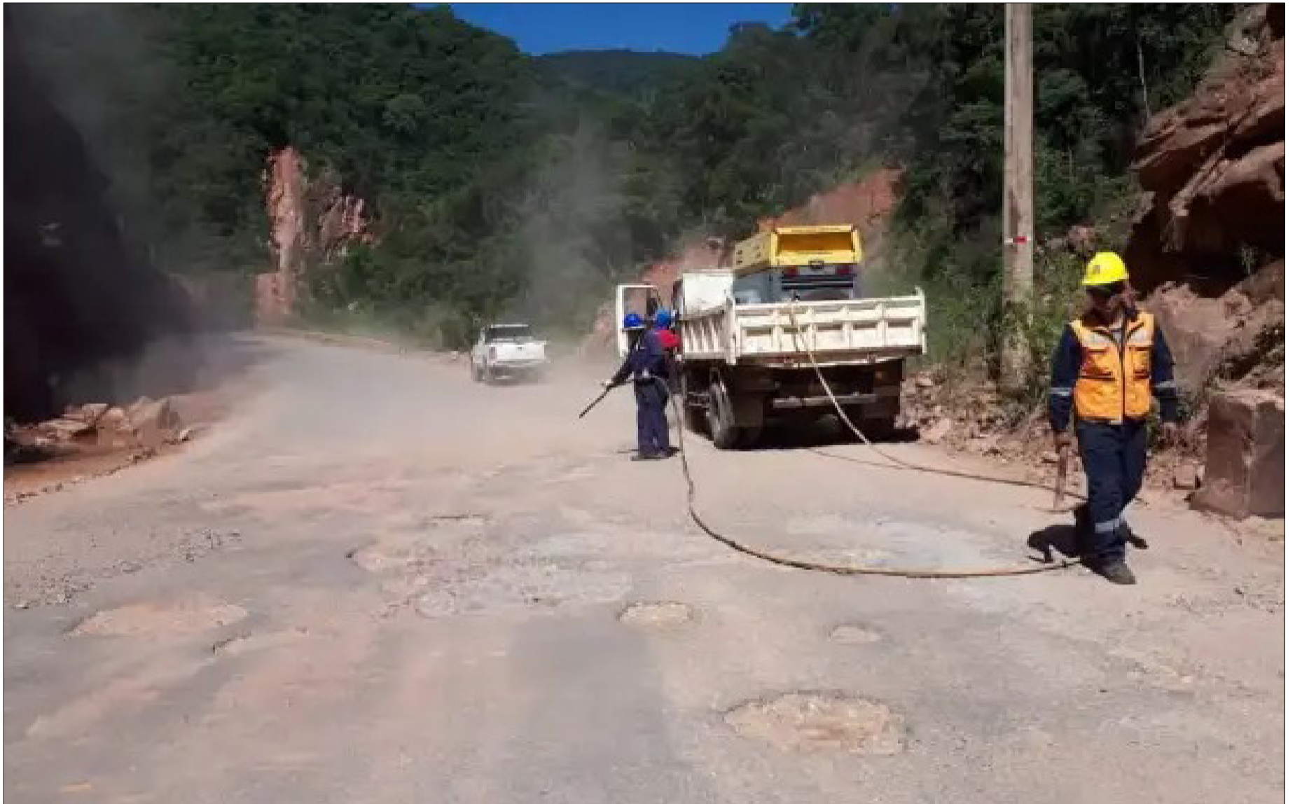
ESTE TRAMO ESTÁ EN RIESGO, OTRA VEZ, DE PARALIZACIÓN.
