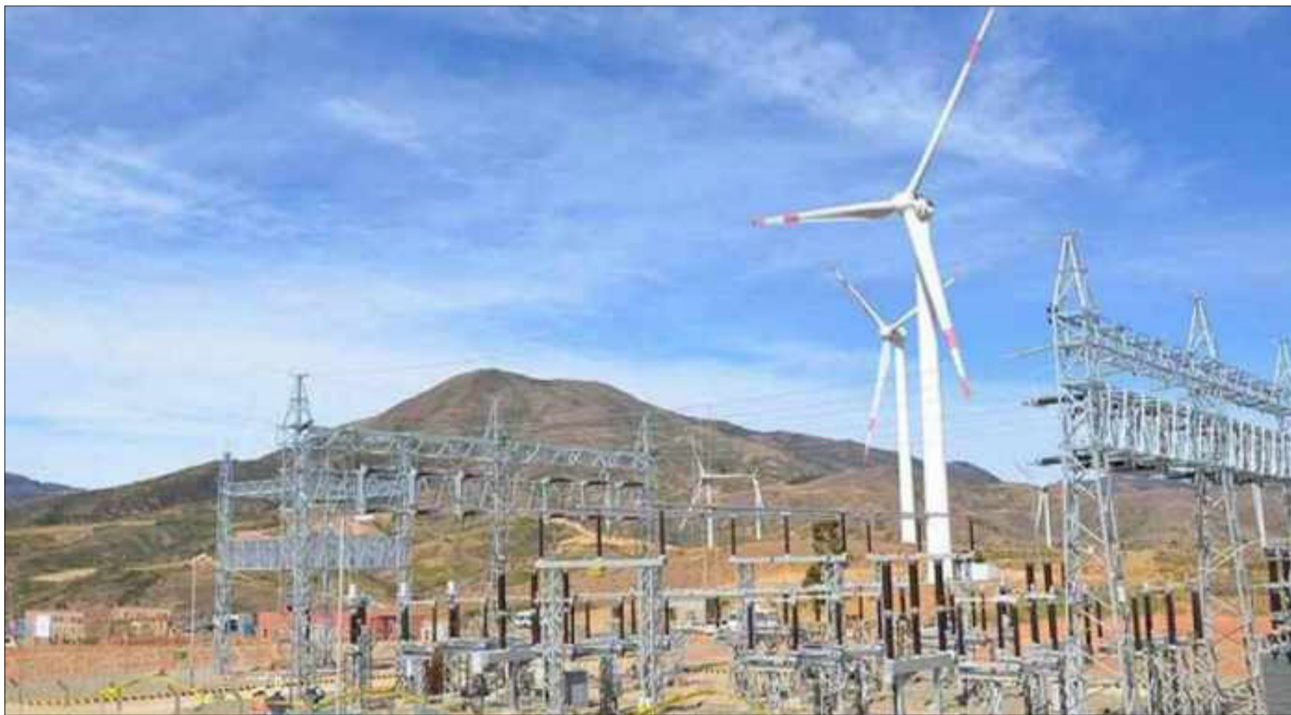
ASÍ YA ESTABA EL PARQUE EÓLICO LA VENTOLERA QUE QUEDÓ EN NADA.
