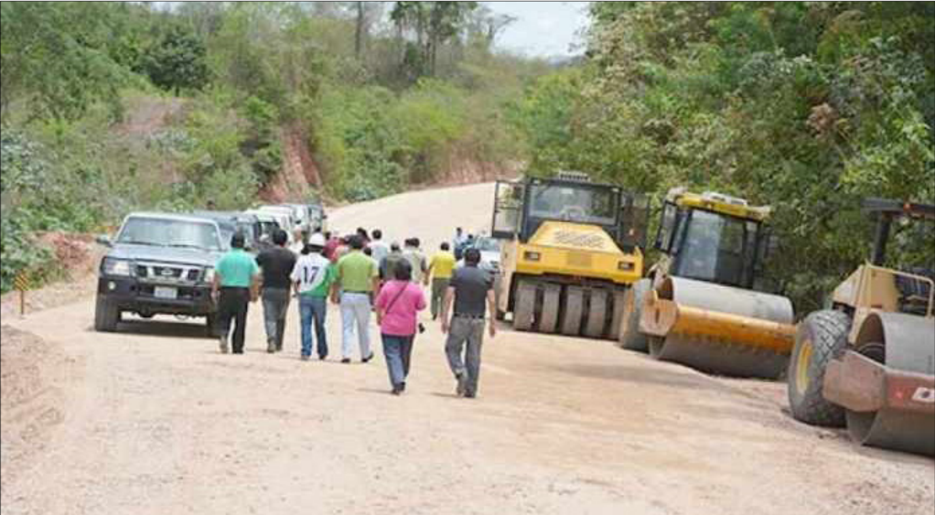
EL ASFALTADO DE ESTA CARRETERA, TAMPOCO SERÁ TERMINADA.
